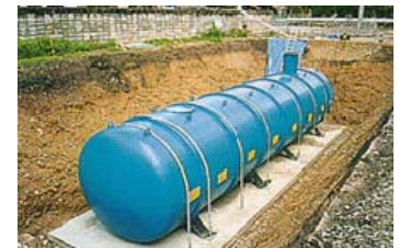
【耐震性貯水槽】
