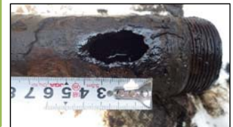
【腐食した埋設配管】
